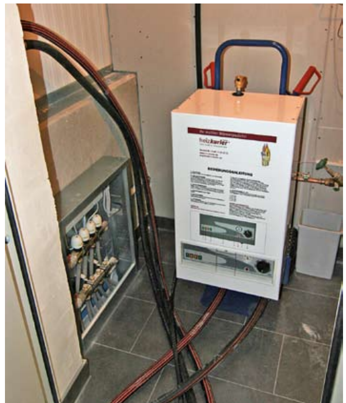
■ Vor Ort werden die mobilen Heizgeräte für die Estrich- und Bauaustrocknung eingesetzt.
