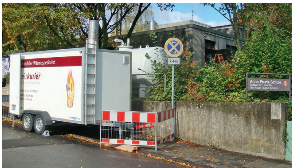
Die 1.000-kW-Anlage vor der Anne-Frank-Schule sorgte während der Sanierungsarbeiten für Wärme und Warmwasser.
