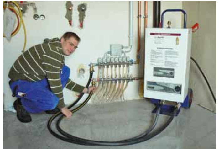
Mobiler „Elektro-heizkurier“ (22 kW) im Einsatz.
